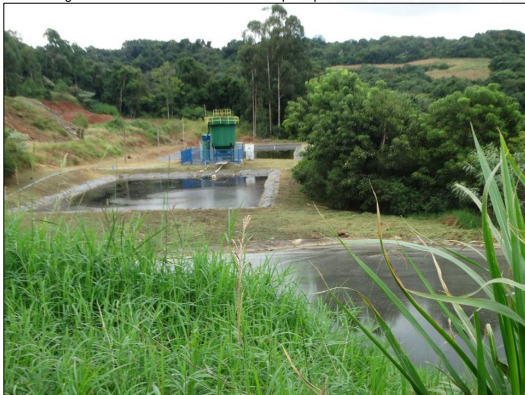
Figura 27: Visão geral do sistema de tratamento do líquido percolado.
