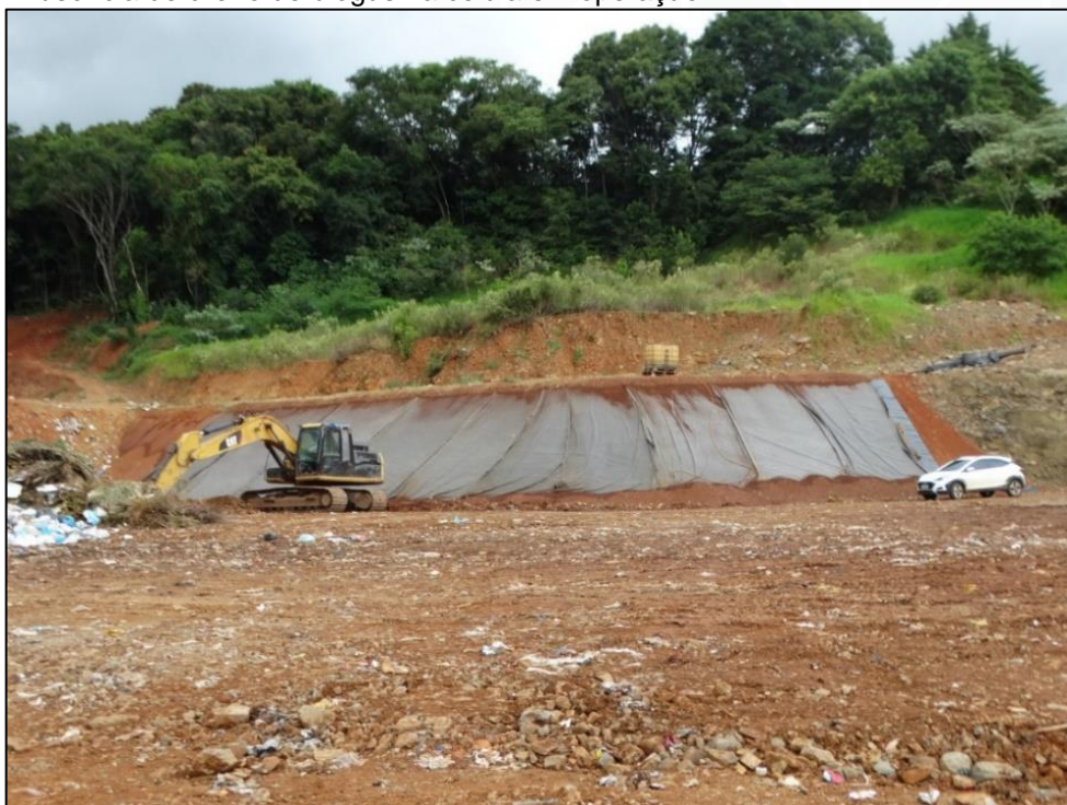
Figura 26: Ausência de dreno de biogás na célula em operação.
