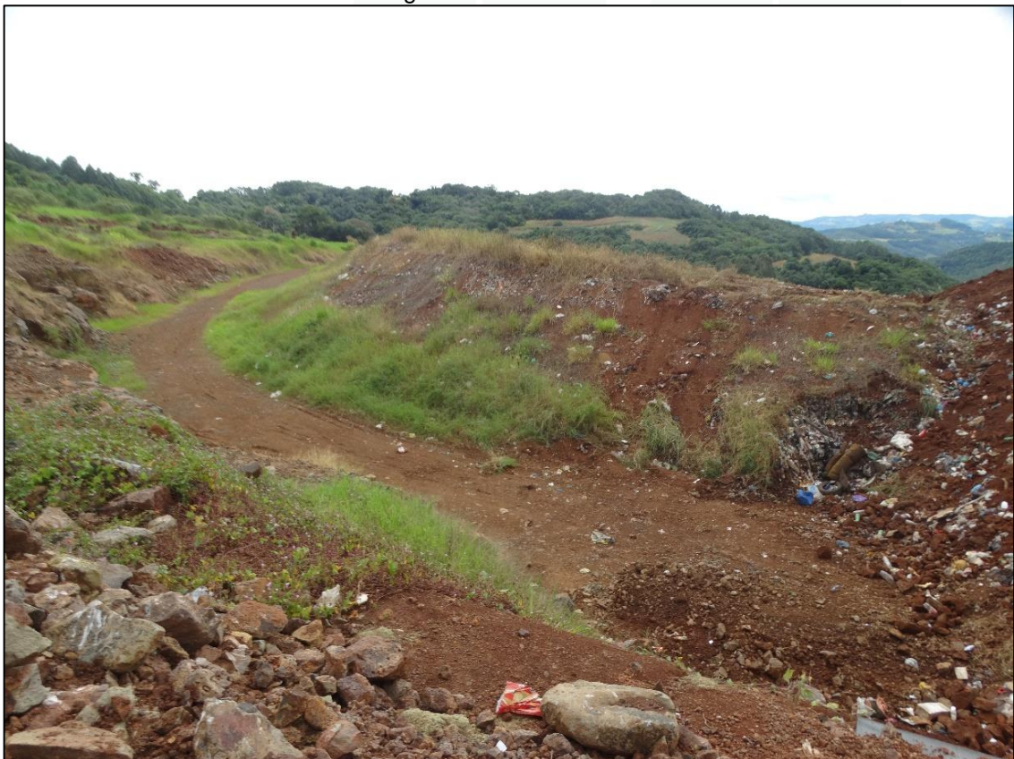
Figura 24: Ausência de sistema de drenagem.
