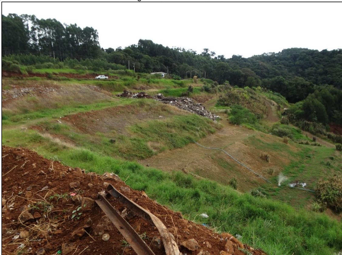
Figura 22: Ausência de sistema de drenagem.
