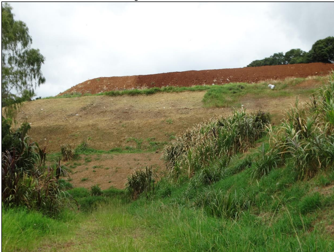
Figura 21: Ausência de sistema de drenagem.
